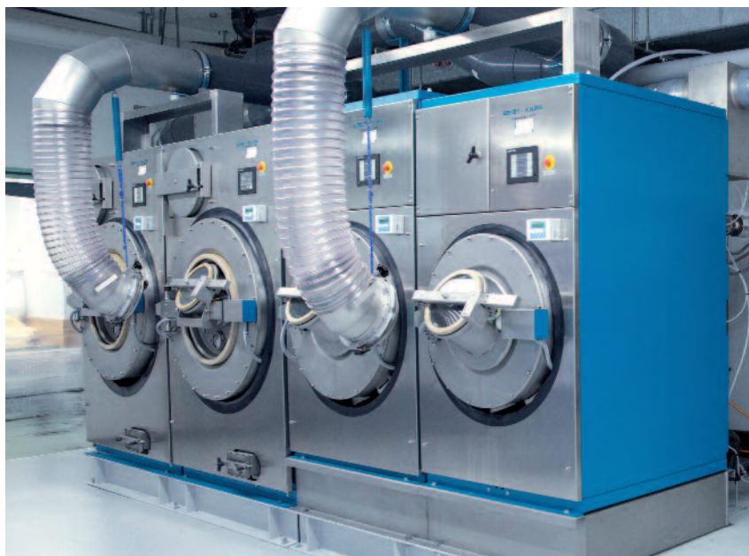
Die vier brandneuen von der Schulthess Maschinen AG installierten Seibt+Kapp Variofex-Waschautomaten mit unterschiedlichen Fassungsvermögen sind an zwei innovative und in sich geschlossene Saug-Zug-Beladesysteme angeschlossen, welche Hygiene auf Top-Niveau ermöglichen.
